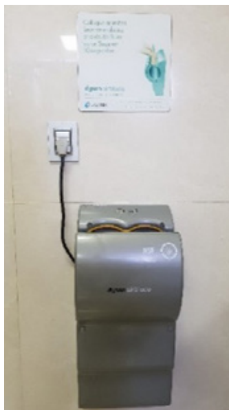
Figura 4. Secador de mãos dyson airblade instalado em banheiro da empresa
