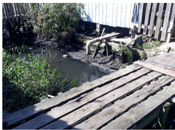
Figura 12: Esgoto sendo despejado na vala a céu aberto
