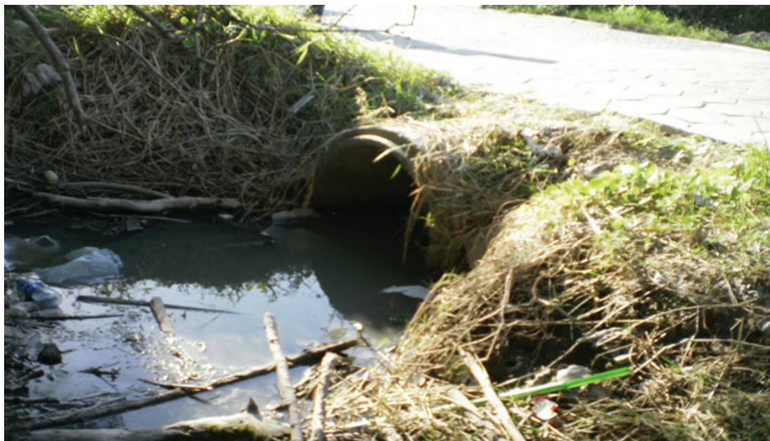
Figura 1. Estado atual da tubulação de passagem de água para o manguezal
