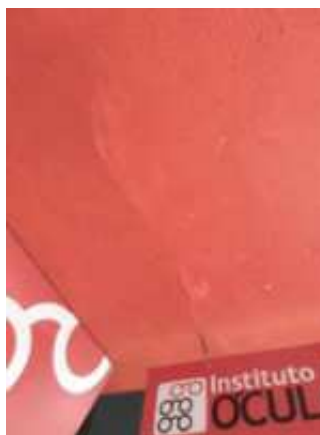
Figura 13 – Umidade/descolamento da pintura e fissuras
