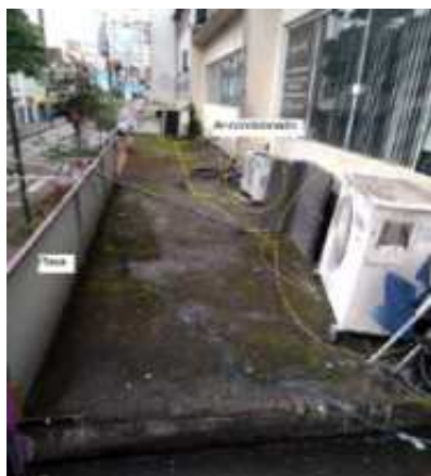
Figura 6 – Sistemas de refrigeração e placa informativa
