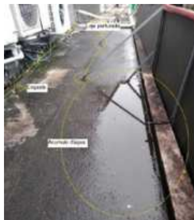
Figura 7 – Perfuração na laje acúmulo de água e placa informativa
