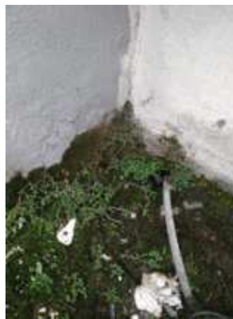
Figura 11 – Ralo de saída d'água obstruído
