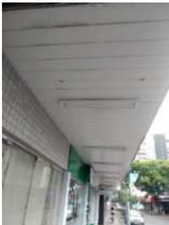
Figura 12 – Bolor/umidade no forro PVC
