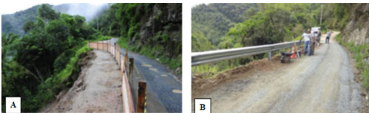
Figura 4. Deslizamento ocorrido dia 23 de out. de 2015 (A) e (B).
