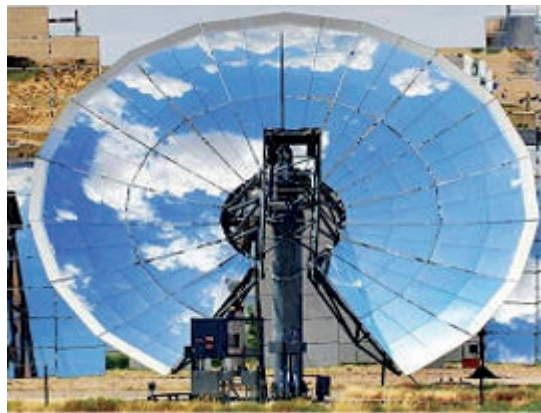
Figura 14. Gerador prato parabólico de 25kW do Laboratório Sandia
