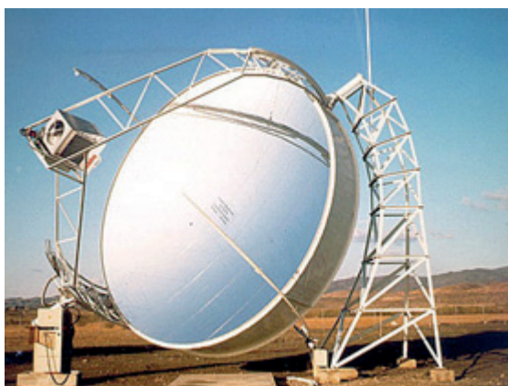
Figura 17. Sistema DISTAL I em operação na Plataforma Solar de Almería
