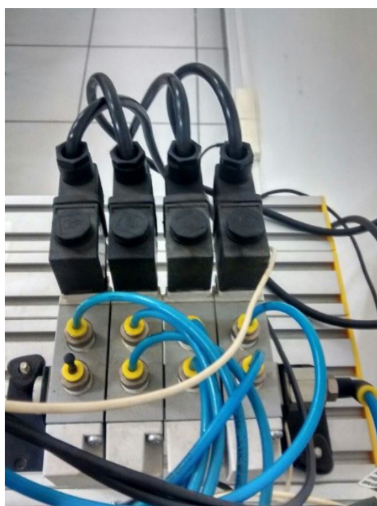
Figura 1. Válvulas solenoides e ligação da parte pneumática
