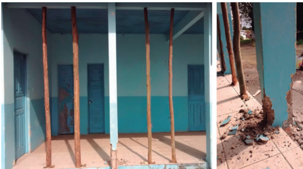
Figura 3. Estrutura escorada e retirada do concreto
