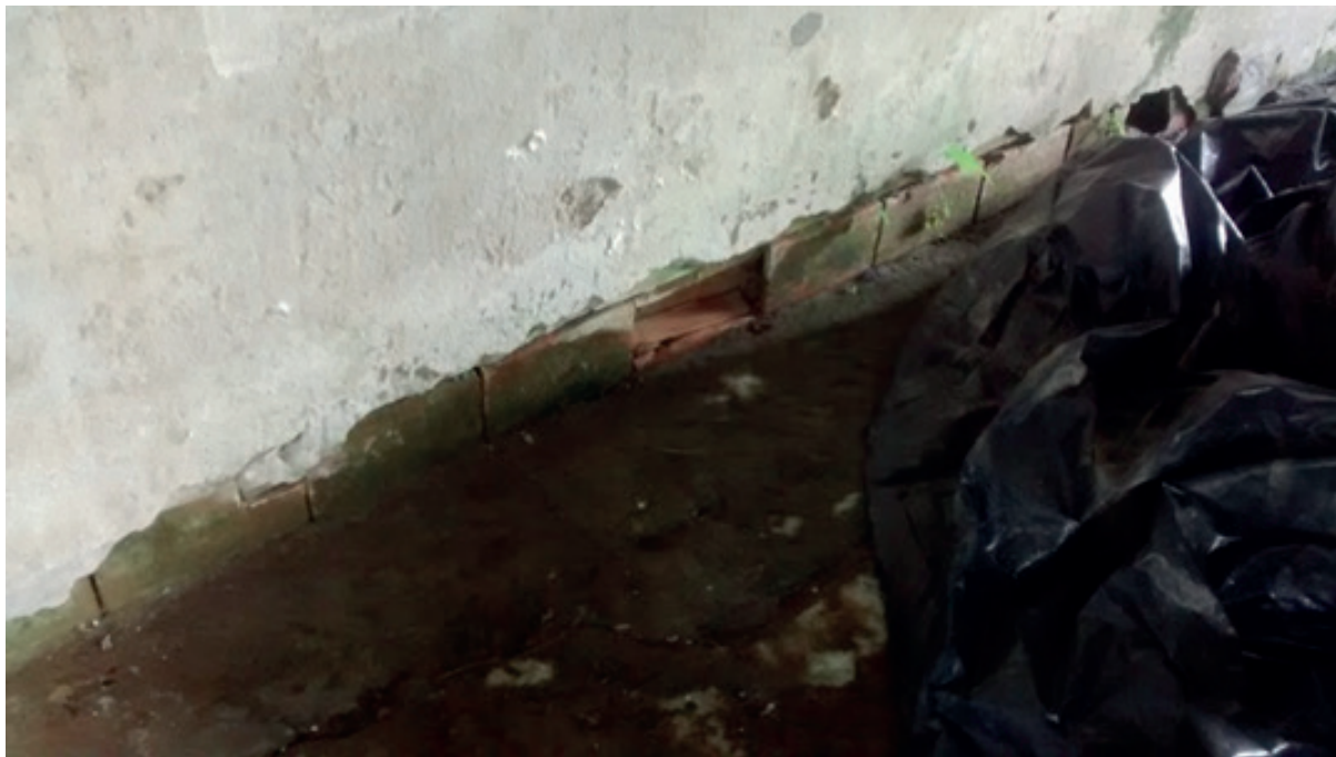
Figura 2. Piso com infiltração
