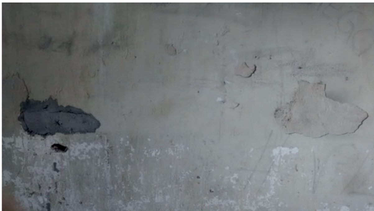
Figura 4. Desprendimento de reboco causado por umidade e falta de manutenção
